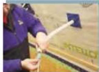
Kabel durchführen STOPPA am Durchdringungspunkt mit der Hand stützen und Kabel durch das vorbereitete Loch ziehen.
